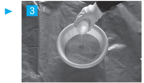
3 充填材と水を混ぜる 硬化が早いため使用する面積に合せて必要な分だけを計量して混ぜて下さい。(1kgあたり水110cc)
